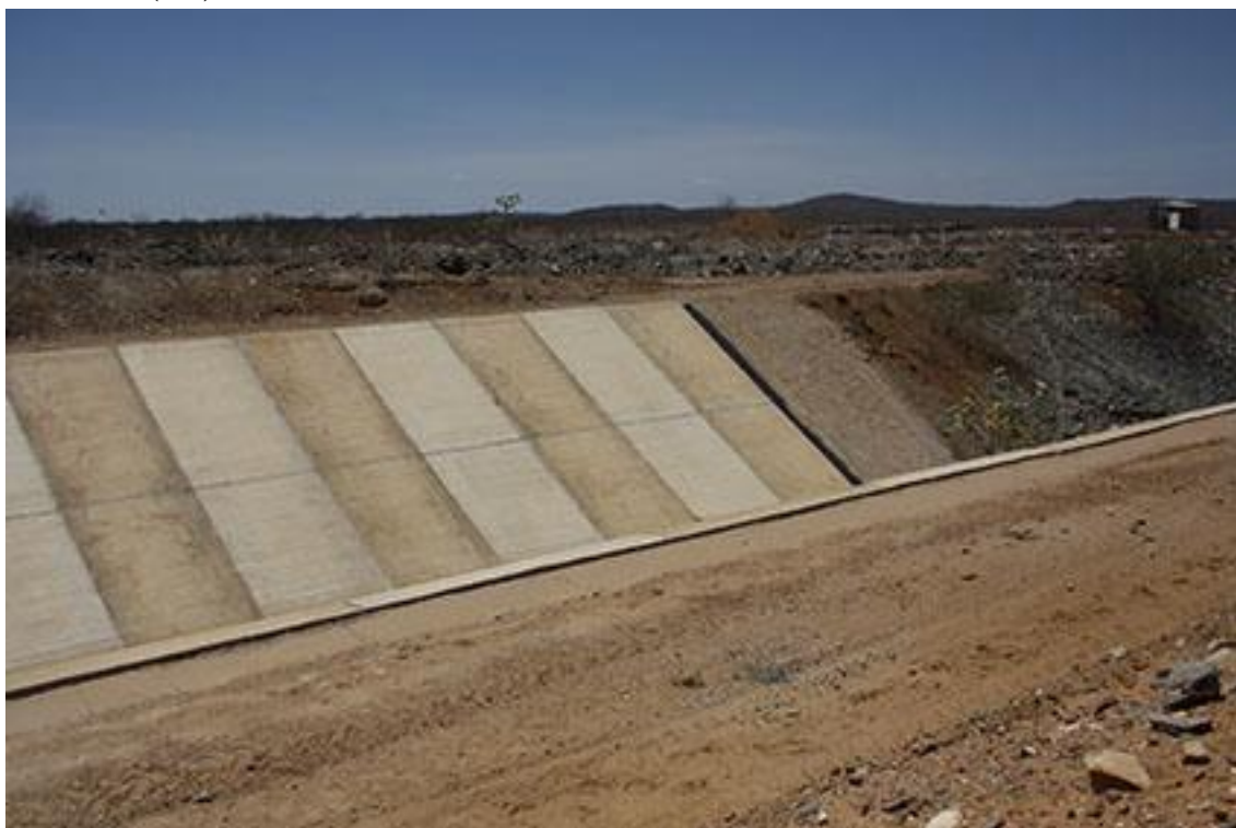
Fotografia 29: Imagem canal do Eixo Norte. Trecho em construção. Município de Cabrobó (PE).
