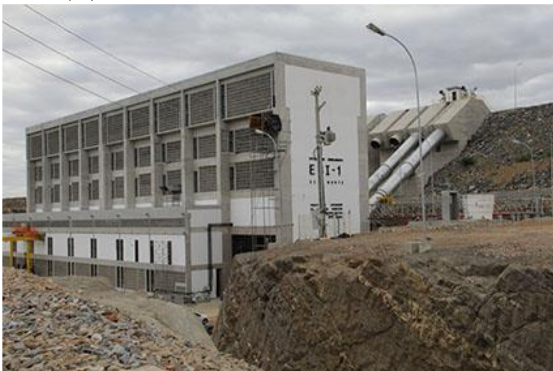
Fotografia 33: Imagem Usina de Bombeamento EB1. Eixo Norte. Município de Cabrobó (PE).
